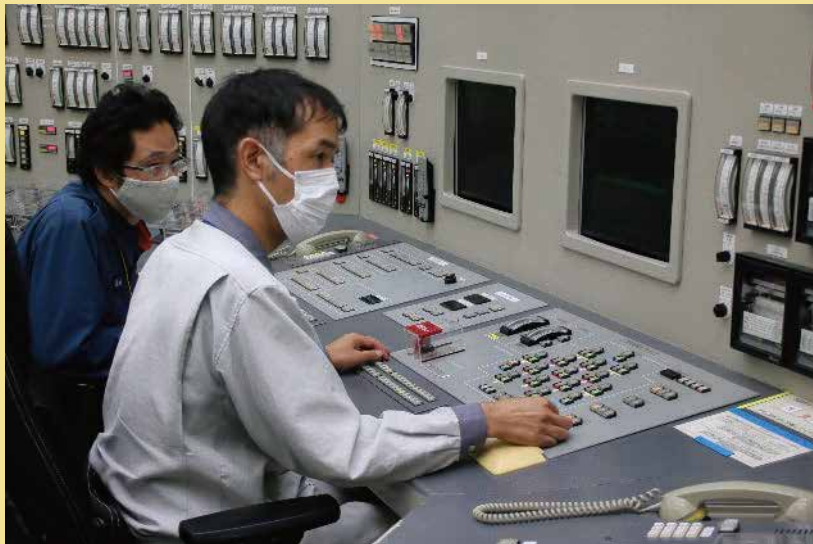
運転再開時の制御室の様子
